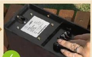
4 トランスの設置
